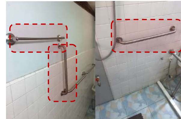
ราวกันลื่นตรง 5 ชุด บริเวณผนังและส่วนอาบน้ำ
