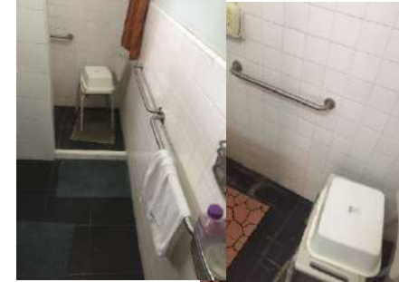
ราวกันลื่นตรง 3 ชุด บริเวณผนังและส่วนอาบน้ำ
